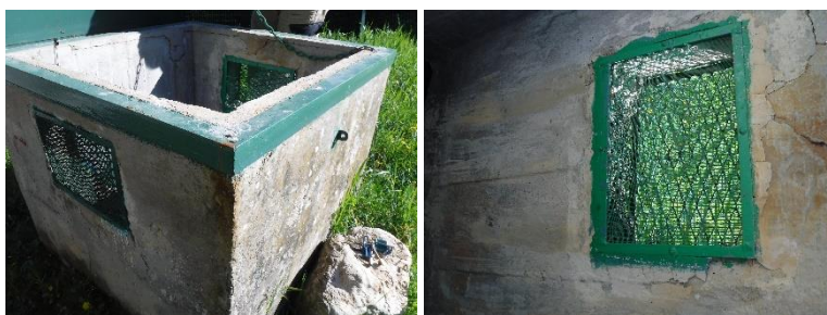
Figure 8 : Anomalies constatées en 2020 sur le site de la source d'Evenos
