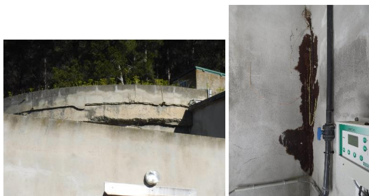
Figure 6 : Anomalies constatées en 2020 sur le réservoir Font Vive
