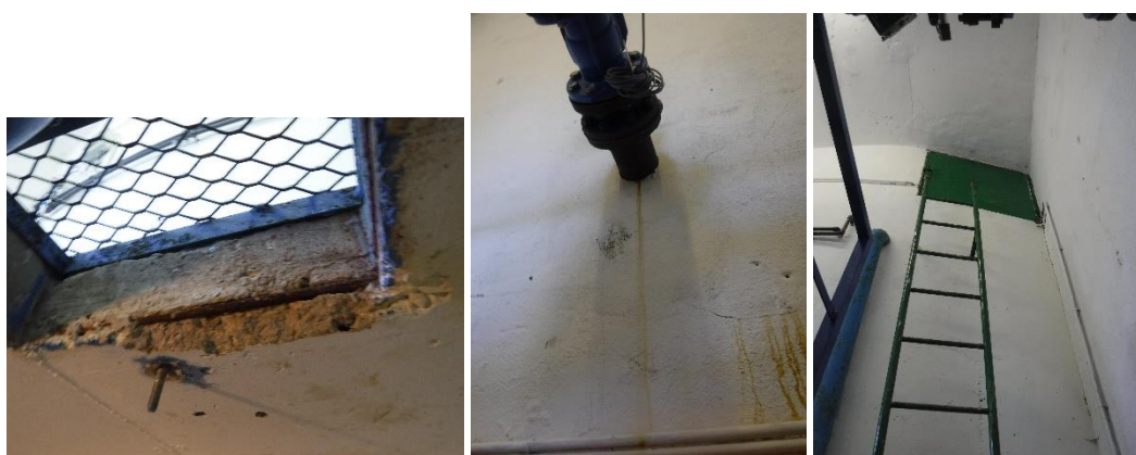
Figure 7 : Anomalies constatées en 2020 sur le réservoir de la Reynaude
